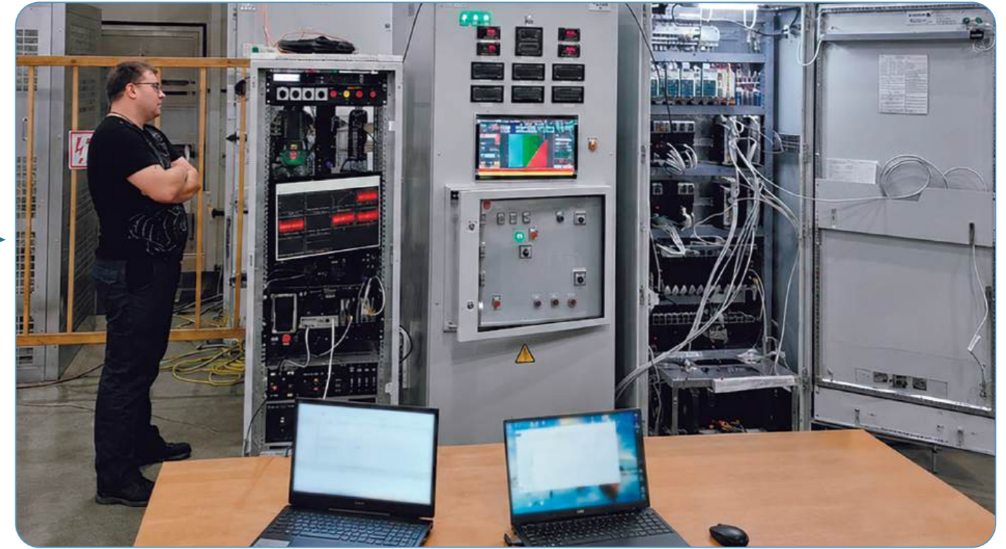
Фото с проведения испытаний на полигоне НПП "ЭКРА" в г. Чебоксары
